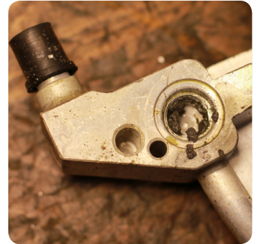
冷凝器进口可见污物
